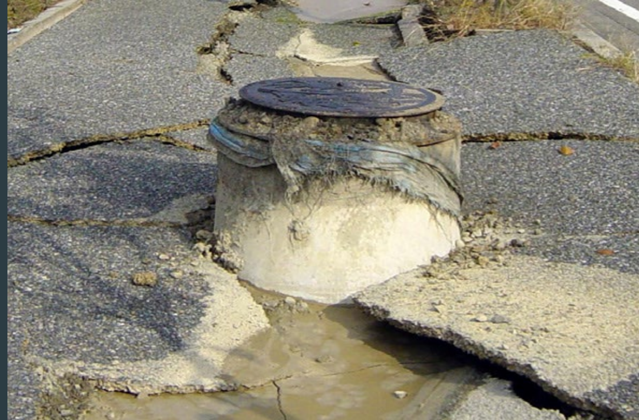
Εκτενής μετακίνηση φρεατίου ύστερα από υγροποίηση του εδάφους
