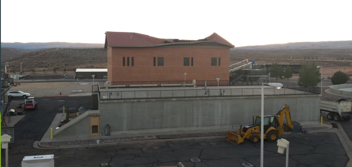
Κατάρρευση ξύλινης οροφής (Γιούτα 2015)
