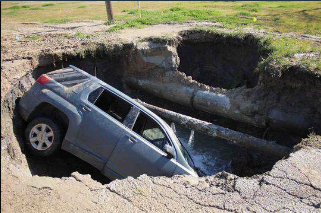
Διαρροή σωλήνα με αποτέλεσμα την ρευστοποίηση του εδάφους (Τέξας 2016)
