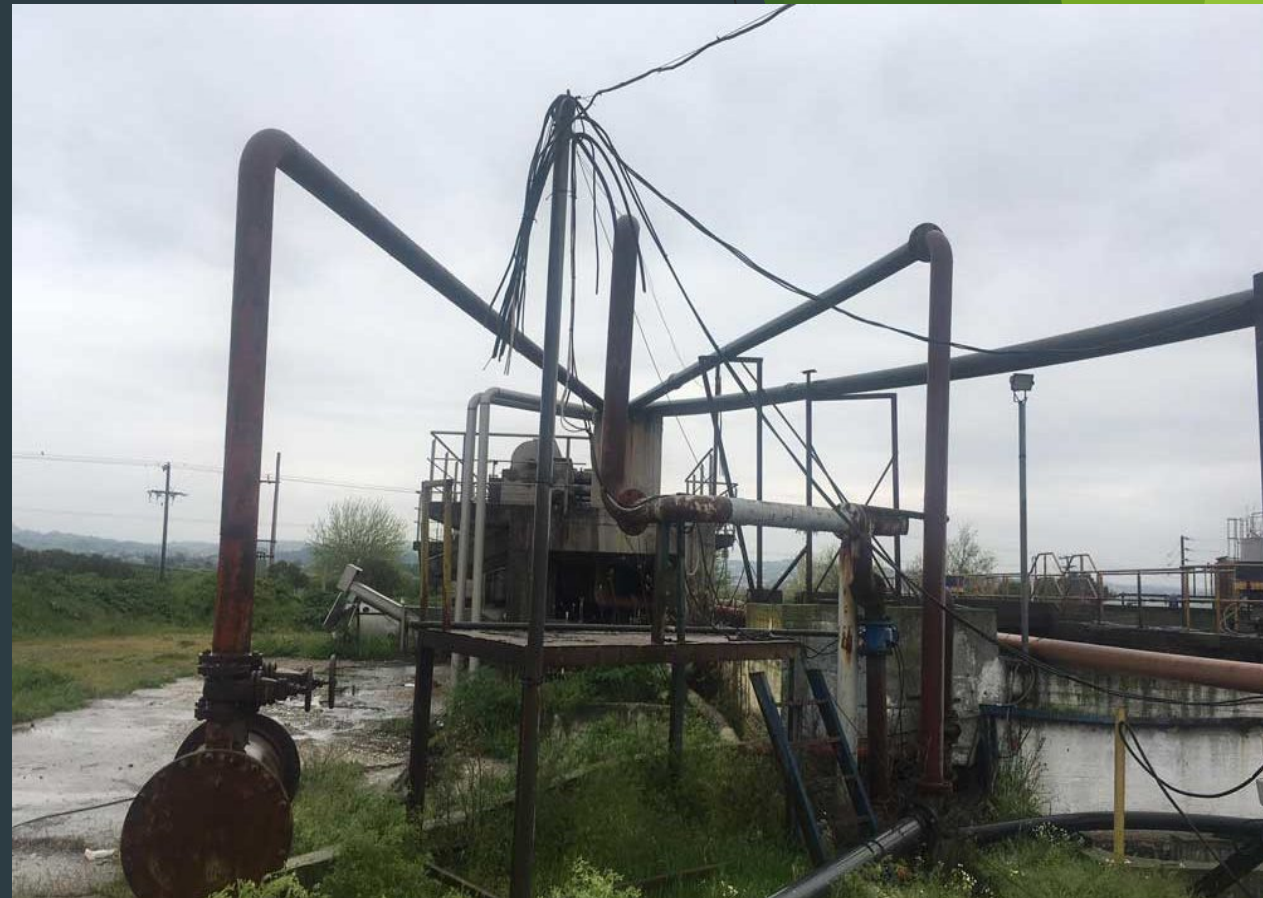
Κλοπή ηλεκτρικού εξοπλισμού με αποτέλεσμα την προσωρινή παύση λειτουργίας (ΔΕΥΑ Θερμης)
