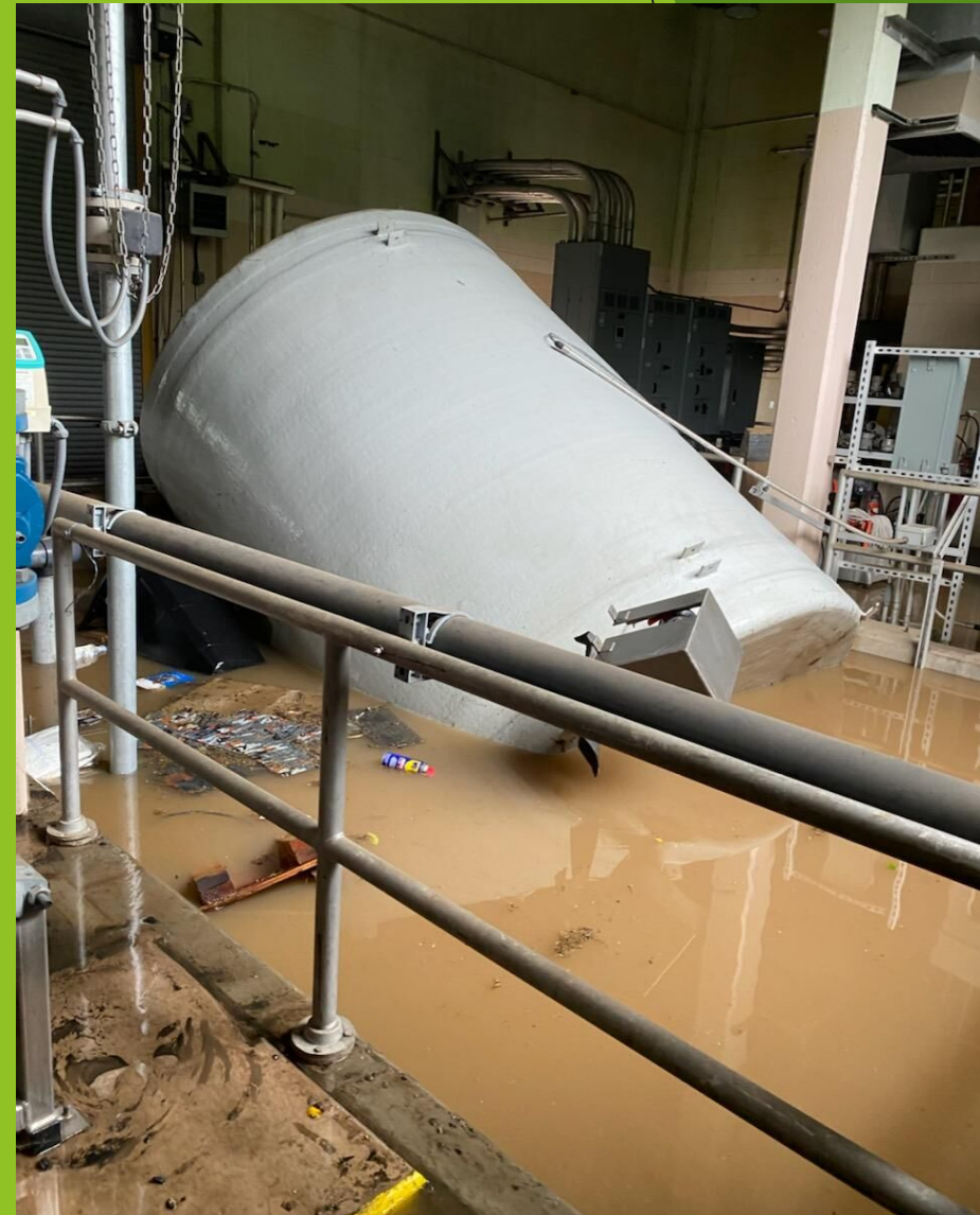
Πλημμύρα και αστοχία δεξαμενής (Φιλαδέλφεια)
