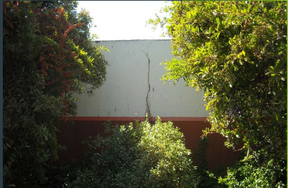
Έντονη ρηγμάτωση σε δεξαμενή καθίζησης (Όρεγκον)
