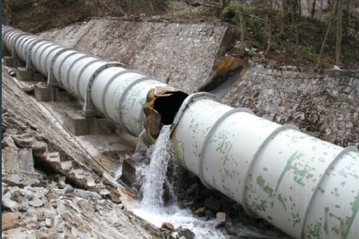
Σπάσιμο κύριου αγωγού και διαρροή (σεισμός του Νεπάλ 2015)
