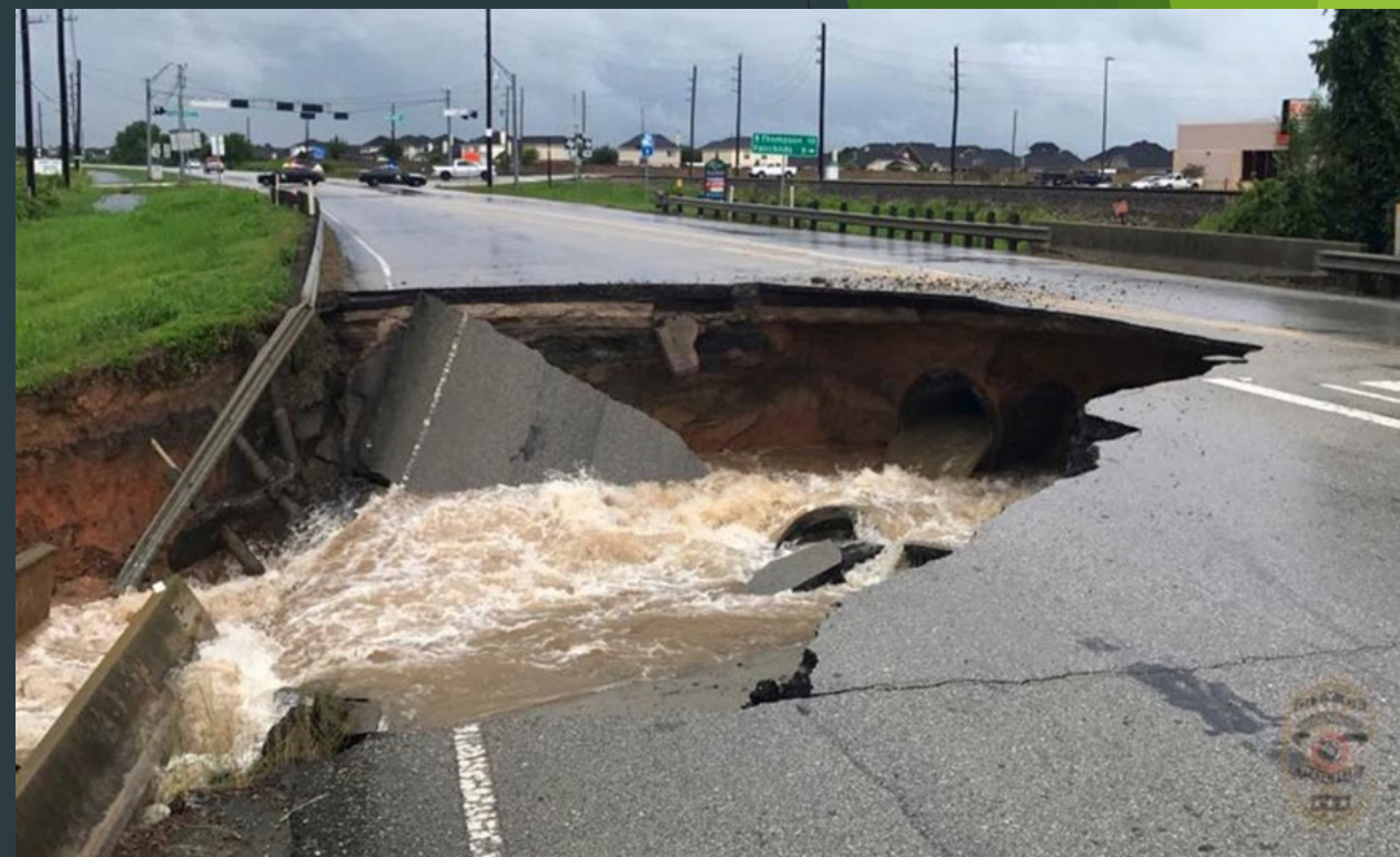
Σπάσιμο αγωγού με αποτέλεσμα την ρευστοποίηση του εδάφους (Τέξας 2017)
