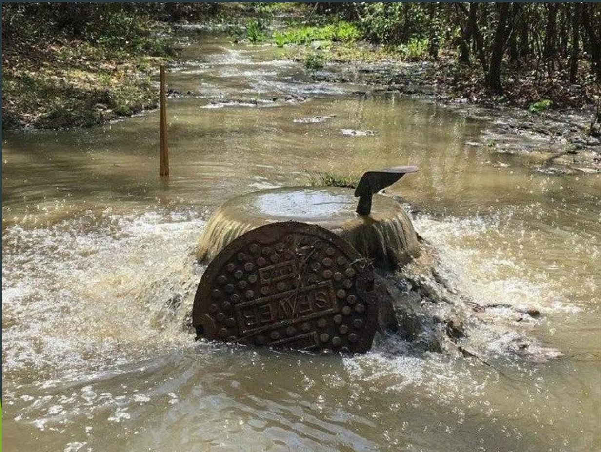
Υπερχειλίση και διαρροή λυμάτων σε λίμνη
