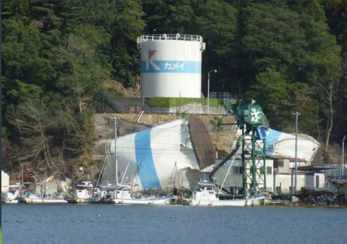
Μεταλλική δεξαμενή καταρρέει ύστερα από τσουνάμι (Ιαπωνία 2011)
