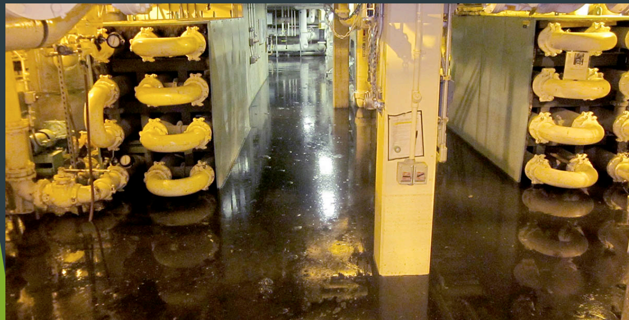
Προσωρινή διακοπή ρεύματος, οδήγησε σε αστοχία όλης της Εγκατάστασης (Σιάτλ 2017)
